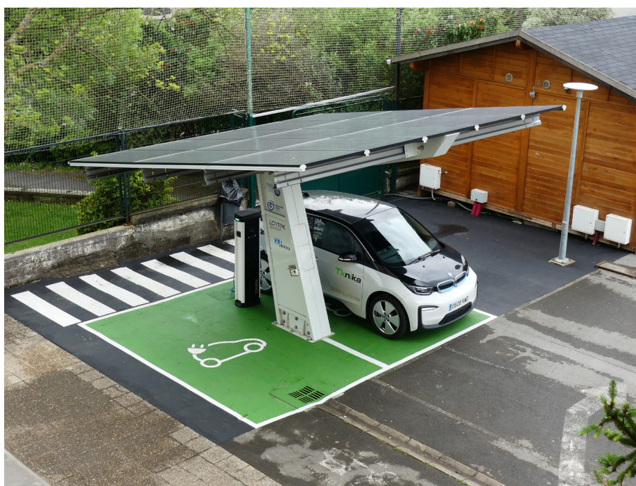
• Vista de la estación de carga de vehículo eléctrico finalizada en el aparcamiento del centro.
