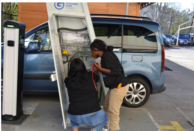
• Alumnas del ciclo Sistemas Electrotécnicos y Automatizados realizando comprobaciones en la instalación fotovoltaica.
