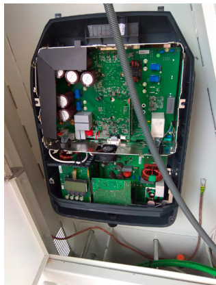
Interior del inversor de la instalación de generación fotovoltaica.
