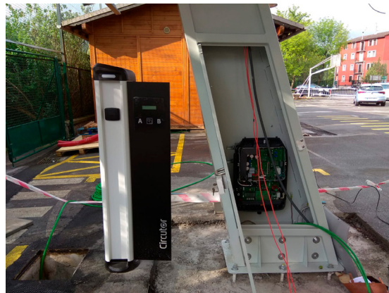
Cableado de la instalación.
